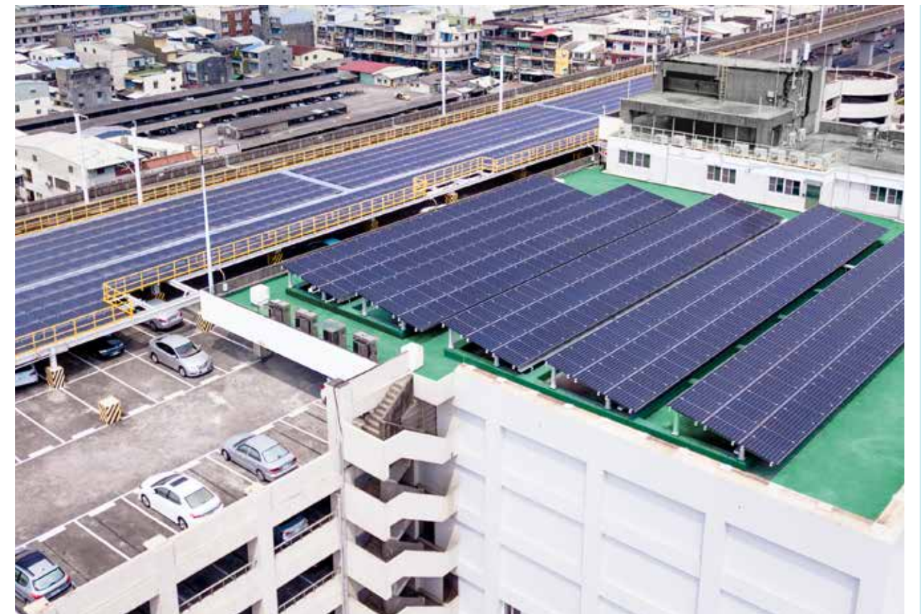
..... 高雄仁武廠太陽能發電
